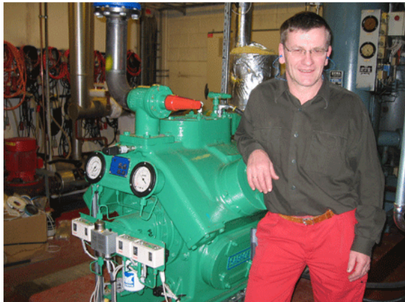
Teknisk sjef Steinar Elgvin foran varmepumpa som bidrar til å redusere CO2-utslippet ved Nortura Tønsberg med 1000 tonn hvert år.
